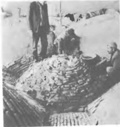
طاق و چشمهها: ۱۵۰ - ۱۵۳. عملیات استحکام بخشی در حال پیشرفت بهران شیوه اصلی. ۱۵۴. بقایای یک روش قدیم جهت فیدبندی بین چهار دهانه طاق و چشمه.
