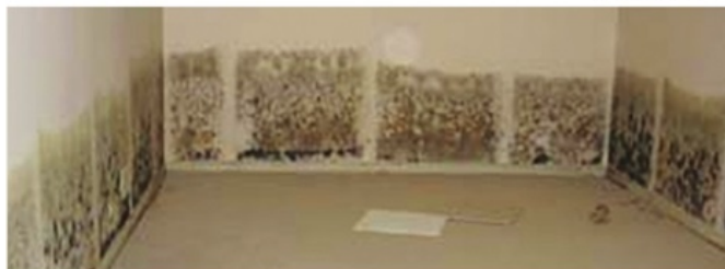
تصویر شماره ۲۸: رشد انبوه کپک در سطوح تحتانی و نمناک دیوارها
