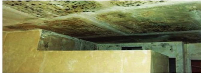
تصویر شماره ۲۶: آثار کپک زدگی روی سقف
