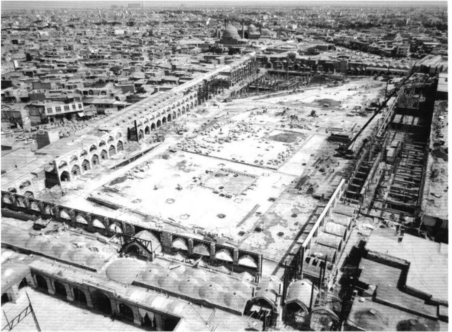
تصویر 130: میدان امام علی در فرایند اجرای فاز دوم (فروردین ماه 1392) - مأخذ آرشیو سازمان نوسازی و بهسازی اصفهان
