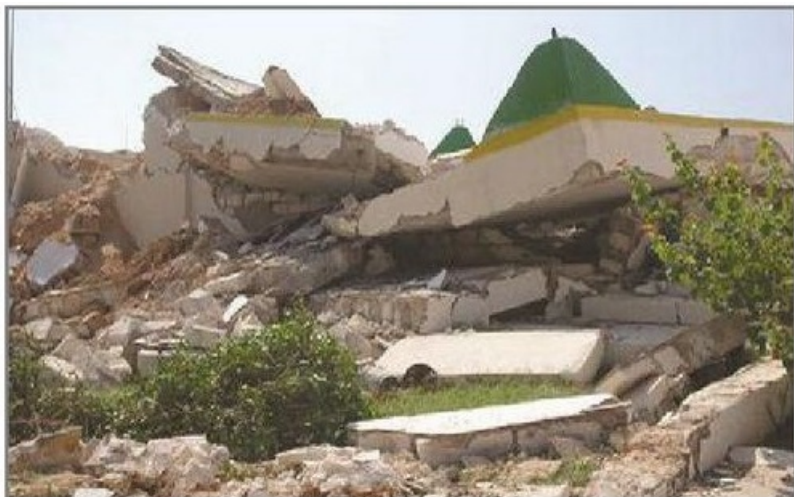
زیارتگاه سیدی عبدالجلیل در جنزور ژس از تخریب
