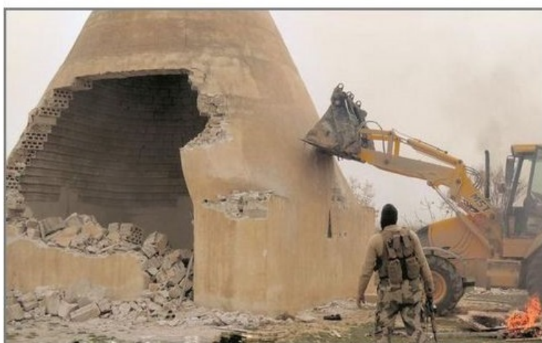
تصاویر تخریب زیارتگاه ابوالعیش در شمال استان رقه
