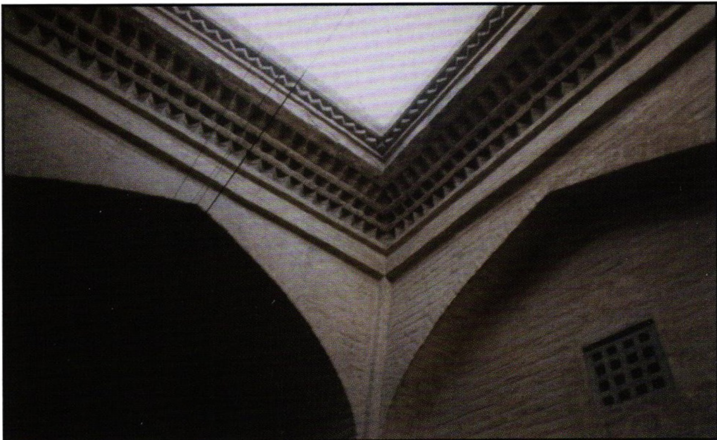
نمایی از زیبا سازی روشنایی راه روی حوضخانه
